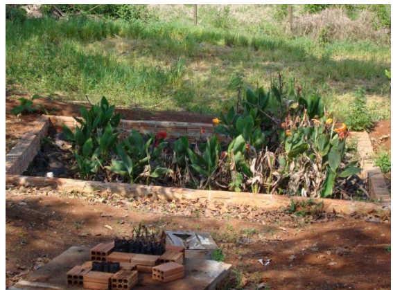
Figura 5 – Estação de tratamento de esgoto por zona de raízes em funcionamento Fonte – Acervo dos autores
