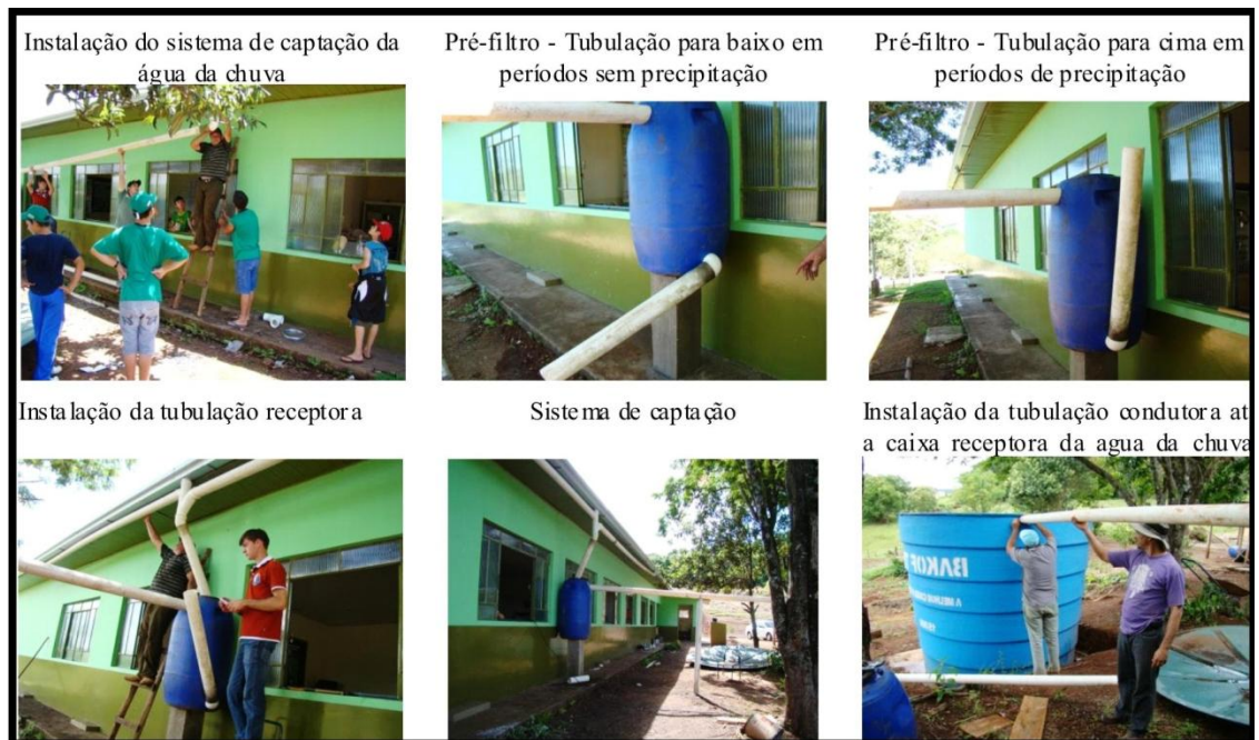
Quadro de fotos 1 – Instalação do sistema de captação da água da chuva
