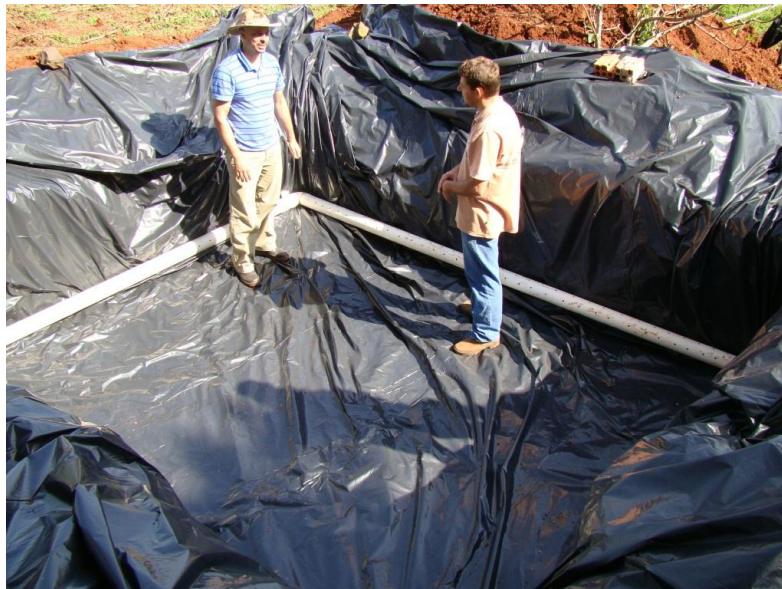
Figura 2 – Estação de tratamento de esgoto por zona de raízes com a lona plástica e tubulação interna Fonte – Acervo dos autores
