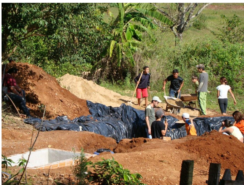
Figura 3 – Preenchimento da ETE com areia grossa e detalhe para a fossa séptica em alvenaria. Fonte – Acervo dos autores
